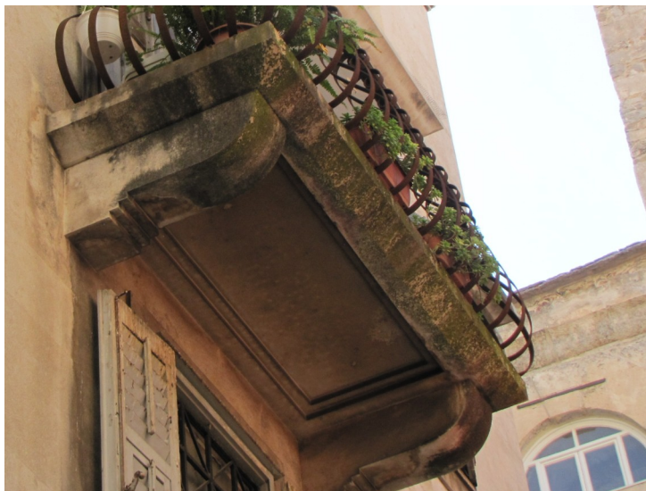
Slika 28 Konzole balkona na adresi Krešimirova ulica 2
