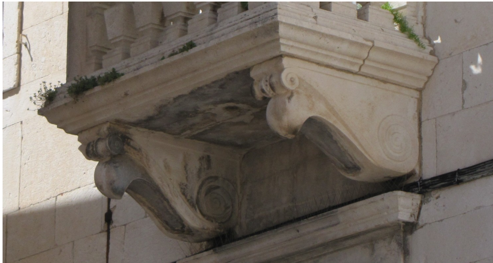
Slika 27 Konzole balkona na adresi Krešimirova ulica 11
