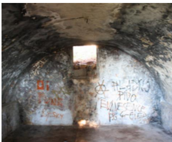
Slika 19. Unutrašnjost barutane na tvrđavi sv.Ivana (preuzeto iz: I. Glavaš, 2017., str. 223., snimio: I. Glavaš)
