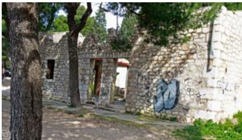
Slika 79. Ruševni ugostiteljski objekt s plesnom terasom
