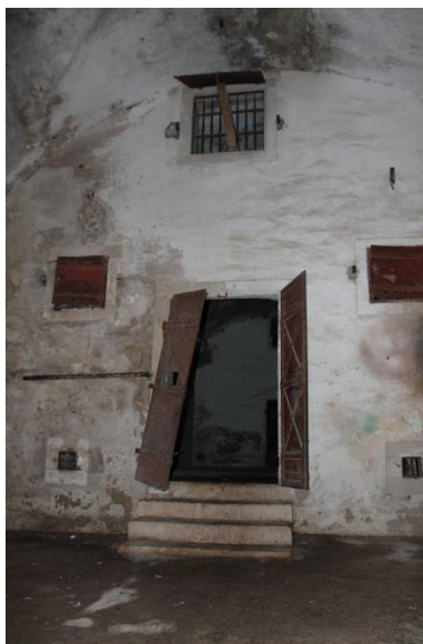
Slika 43. Detalj pročelnog zida barutane
