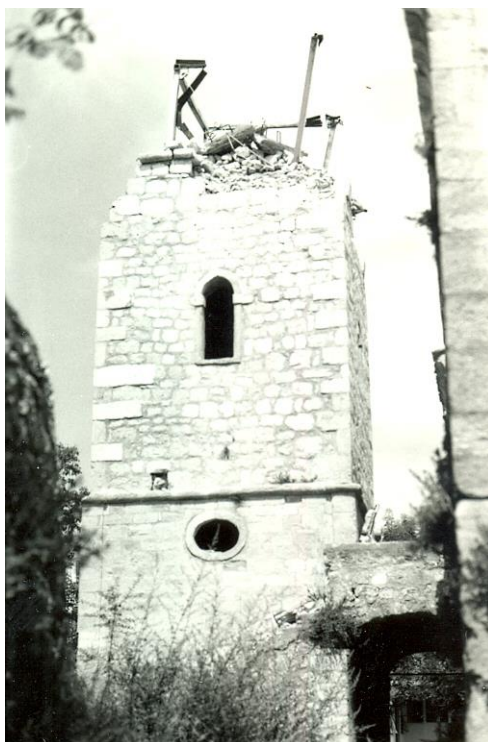
Slika 48. Ratno oštećenje zvonika
