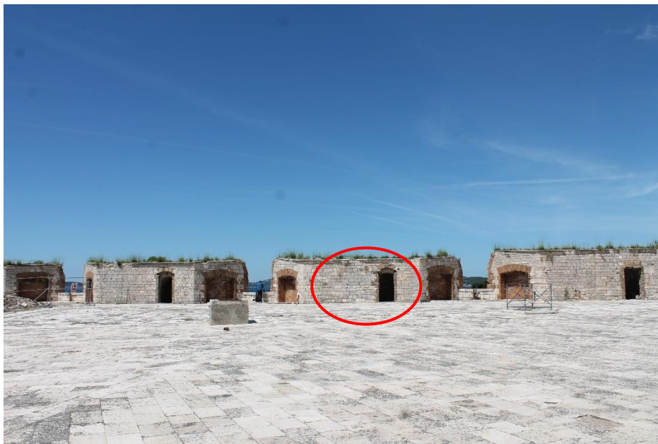
Slika 52. Pogled na zapadnu kortinu tvrđave sv. Nikole, označeno mjesto nadsvođene prostorije unutar kavalijera
