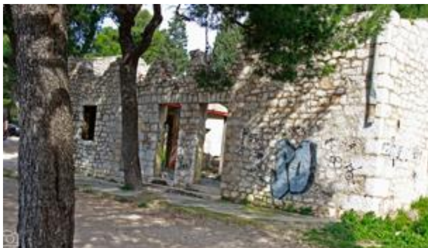
Slika 79. Ruševni ugostiteljski objekt s plesnom terasom
